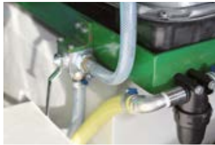
Filtro de agua
